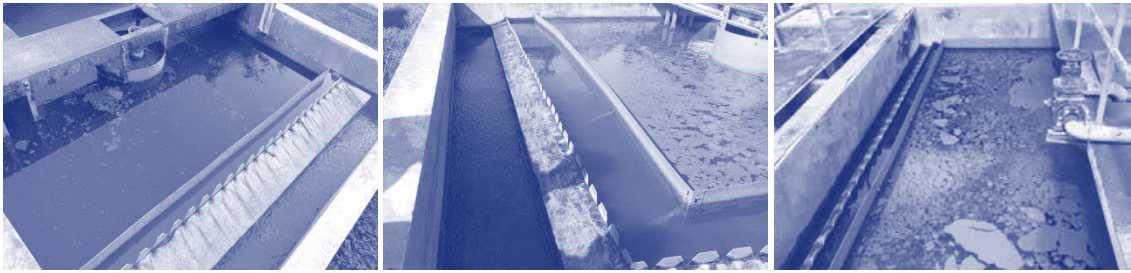
รูปที่ 2-32 เวียร์น้ำล้นและแผ่นกั้นตะกอนลอย
