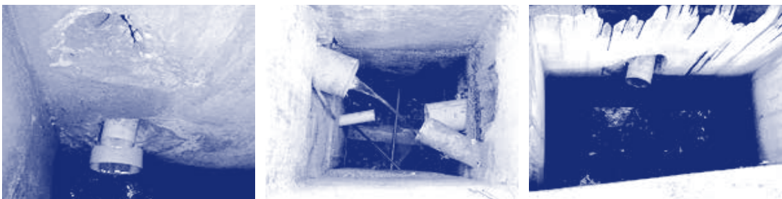
รูปที่ 7-4 ผนังบ่อตรวจแตกชำรุดจากการก่อสร้างและการเชื่อมต่อทำให้น้ำใต้ดินซึมเข้าบ่อตรวจ
