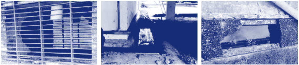
รูปที่ 7-12 มีน้ำขังอยู่ในรางระบายน้ำฝนของโรงพยาบาล
