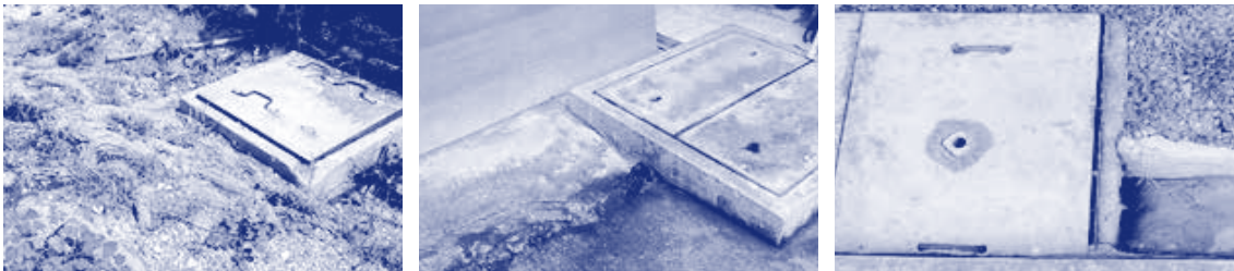
รูปที่ 7-2 บ่อตรวจแตกชำรุดจาก (ก) รากของต้นไม้ (ข) และ (ค) ถูกเจาะเพื่อระบายน้ำล้างถังขยะ
